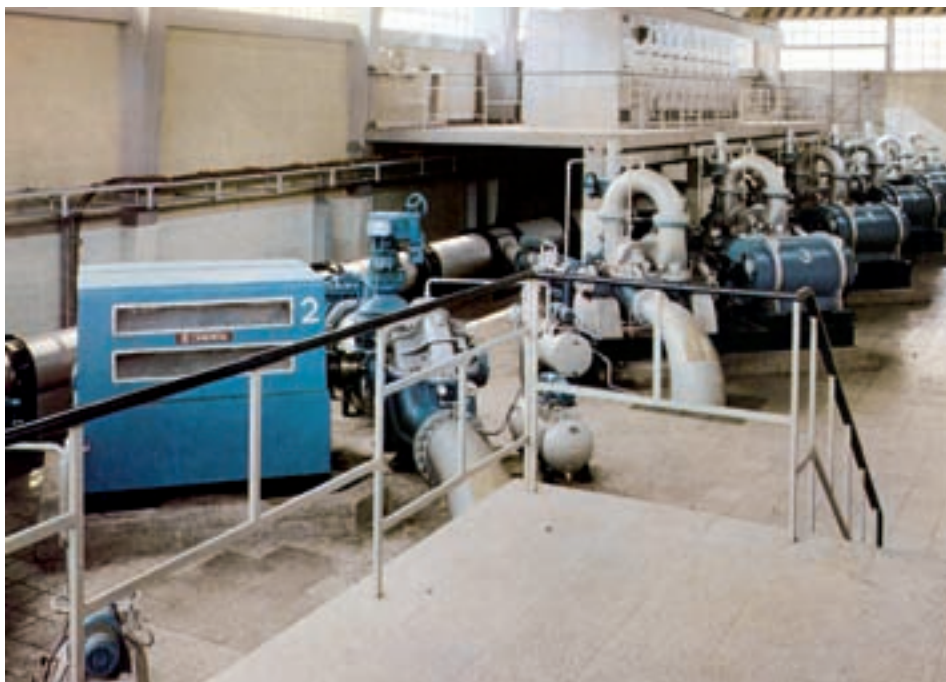
FOTO 18.4: Sala de bombas de Bolueta
